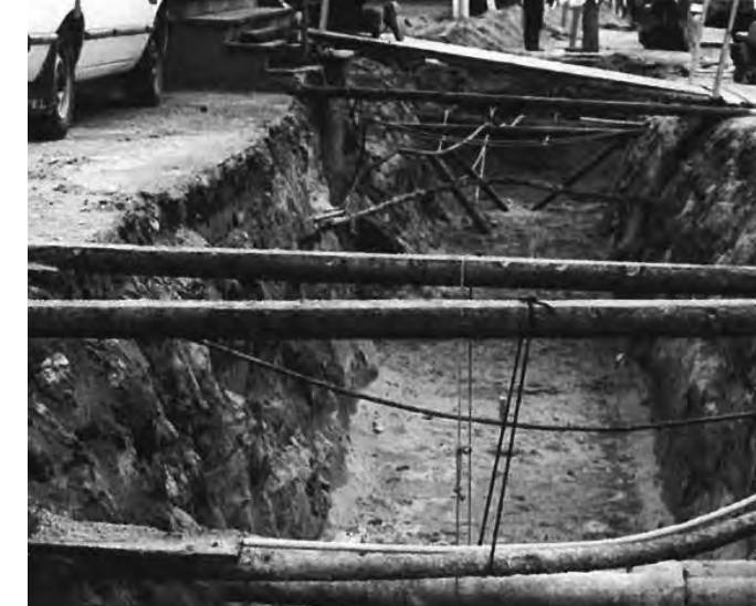
Gravingen i Mo sentrum var ikke ukomplisert med kryssende kabler og rør.
