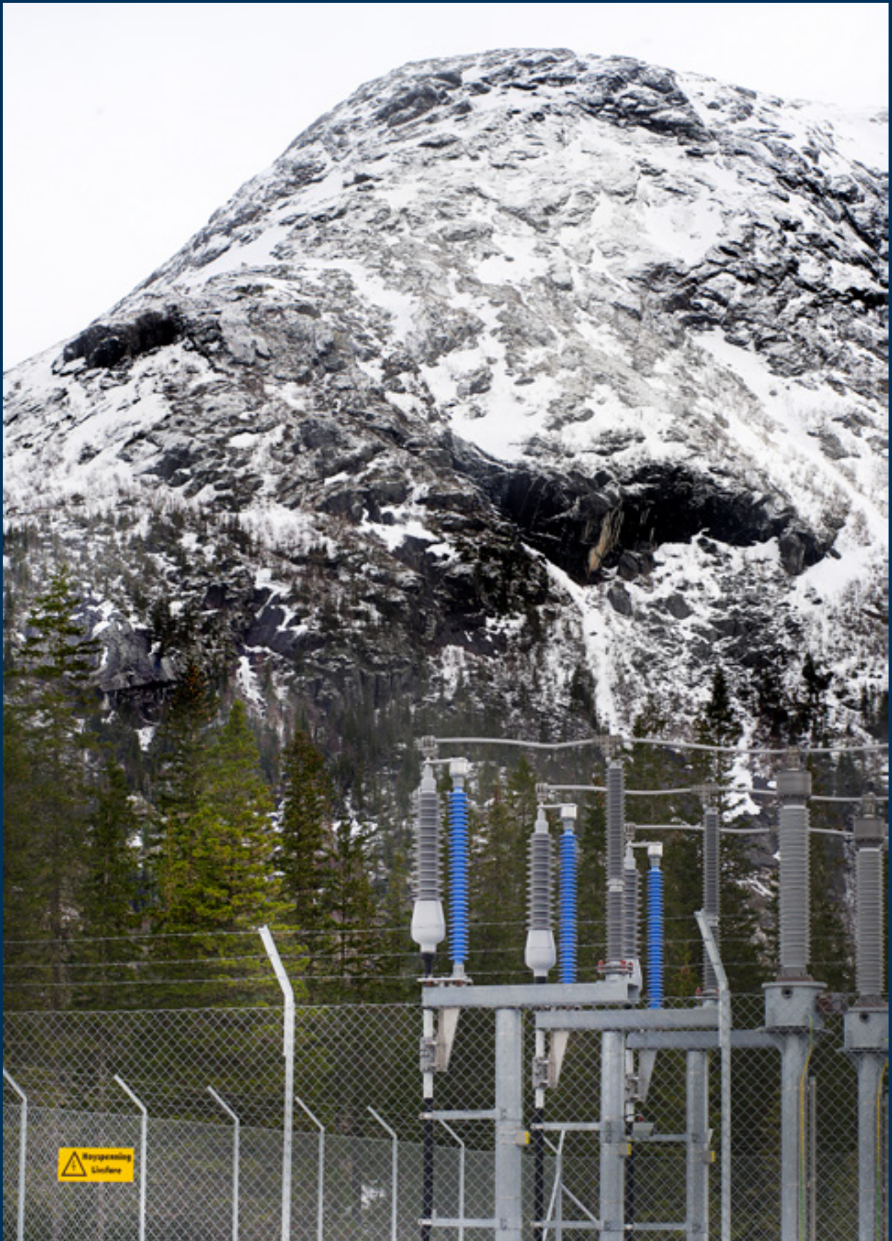
Tosbotn Trafostasjon ble bygget i forbindelse med utbyggingen av våre 5 nye kraftverk i Tosbotn, og bidrar til sikker transport av grønn energi produsert i Tosbotn ut til strømforbrukerne på Helgeland.
